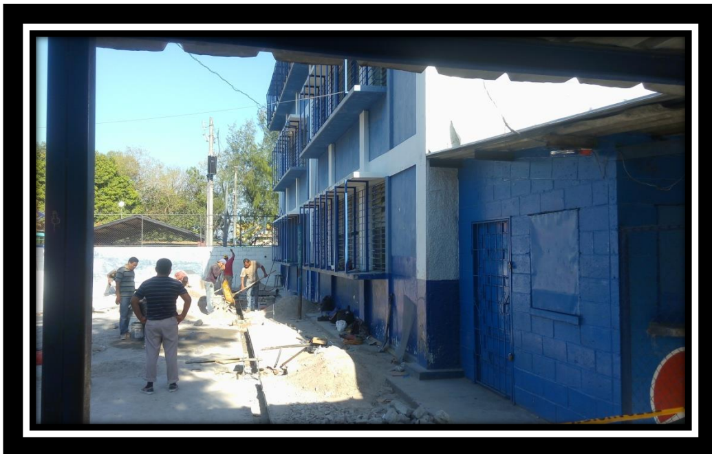
Preparación de aulas para ubicación del COR, proyecto de realización de rampas, cancha techada.
